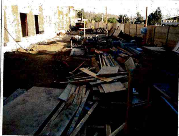
Fotografía N° 6: Diferentes materiales dispuestos sin orden en la zona trasera de la edificación.
