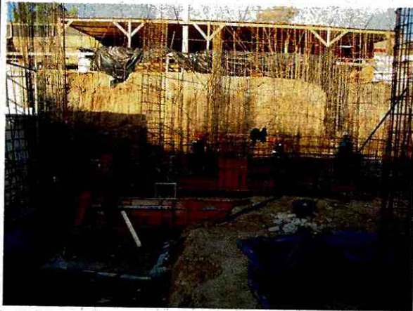
Fotografía N° 3: Excavación existente hacia la Avenida Ollarzá, sin socialzado.
