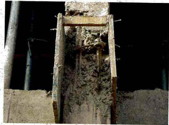
Fotografía N° 2: Pilar exterior con asentamiento de áridos, ubicado en el eje ZZ entre ejes 11 y 26.
